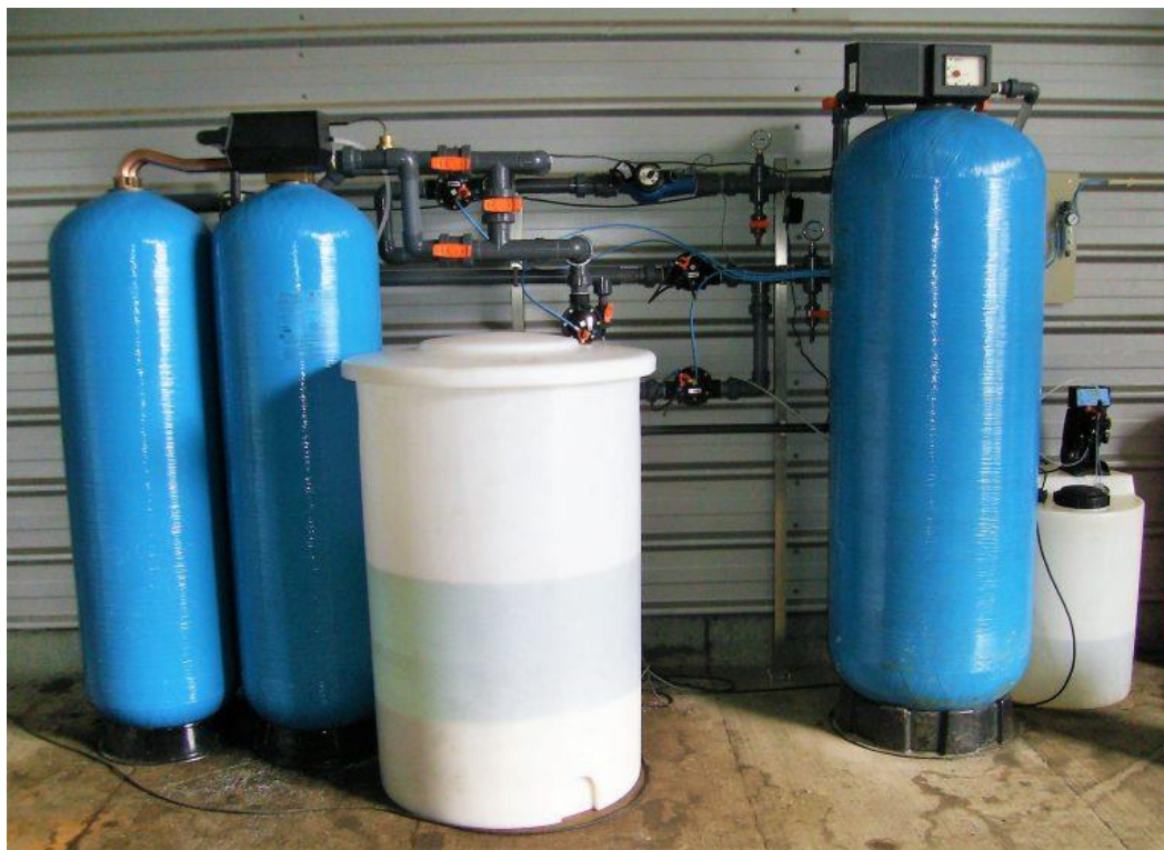
Figura 3- Unidade industrial de permuta iónica [2]
