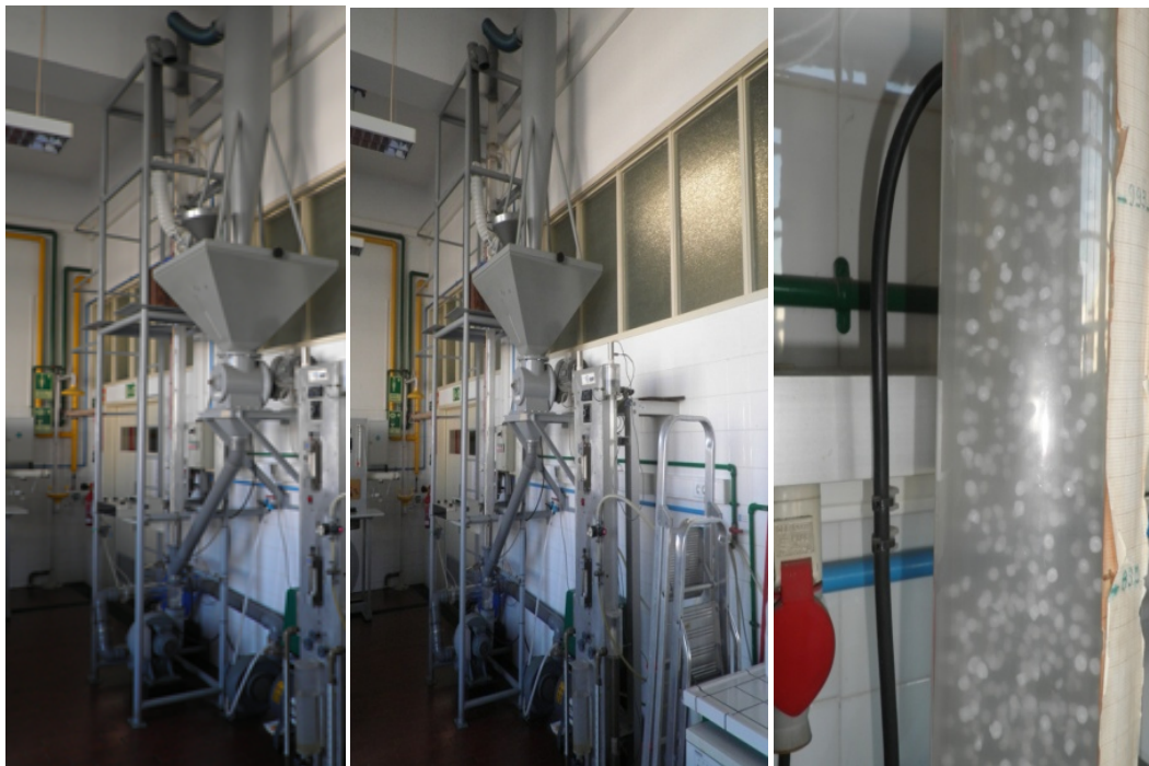
Figura 4. Instalação de transporte pneumático - Fluidização de partículas de polímero.
